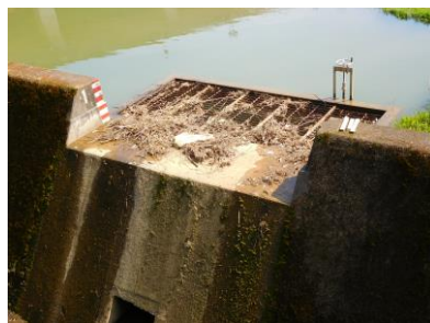
浮遊ゴミがスクリーンに堆積
